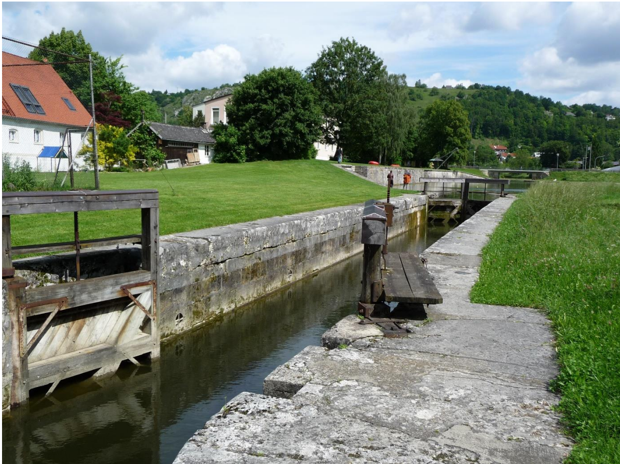
Schleuse 1 am historischen Ludwig-Donau-Main Kanal bei Kelheim, Foto von Andreas Schraner (Wasserwirtschaftsamt Landshut)
