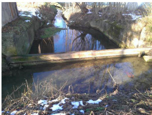
Abbildung 7: Absturz am Schweinbach im Bereich der LA 14
