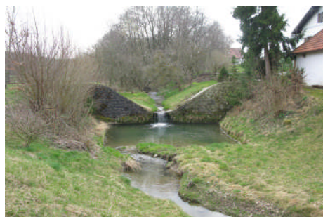
Abbildung 20: Absturz in Tiefenbach
