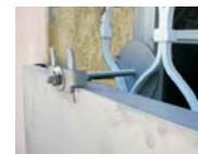
▲ Detail des mobilen Fensterverschlusses
